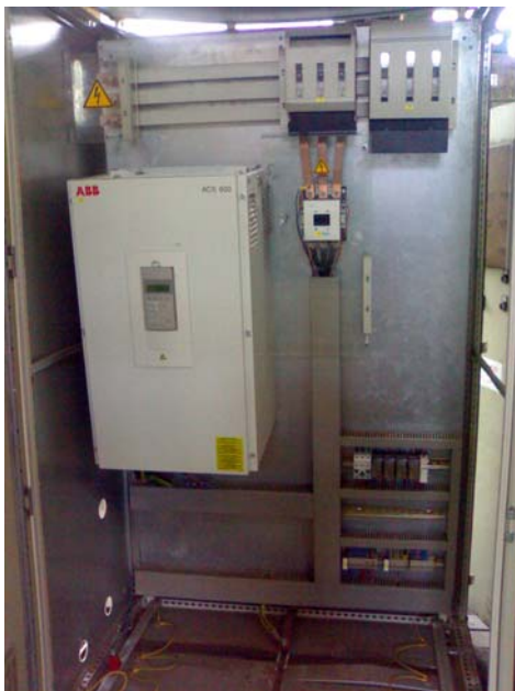
Aționare pentru motor asincron cu rotor în scurtcircuit de 132kW Beneficiar: Cuprom Baia Mare
