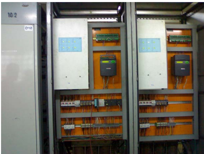
Acționări pentru motoare de curent continuu de 300kW.
