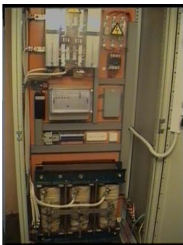
Redresor pentru galvanizare. U_n=24V I_n=350A Beneficiar: SC ALMA-ACIM SRL– Baia Mare
